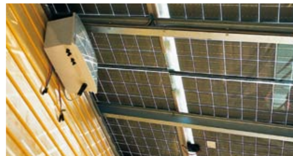
Untersicht Photovoltaikdach mit Wechselrichter
